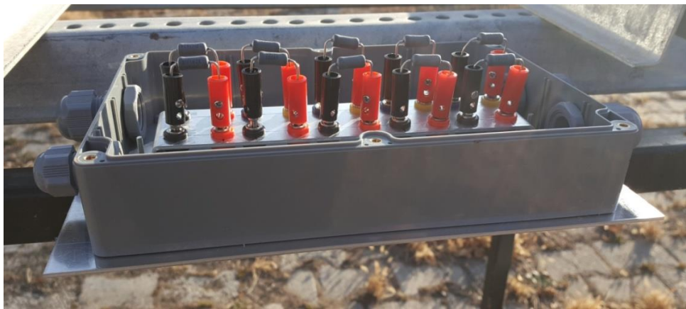
Şekil 3.7: Bağlantı kutusunun görünümü
