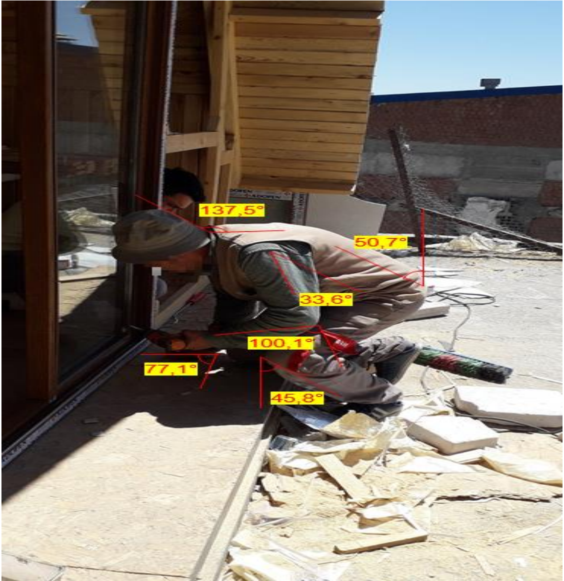
Şekil 32. Firma 3: Bungalov Ev Kapı Montajı İşlemi 1. Çalışana Ait En Riskli Çalışma Pozisyonları.
