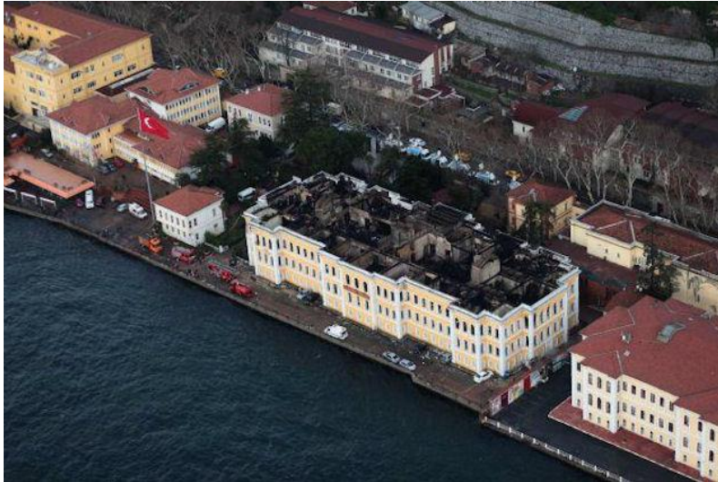
Fotoğraf 11. Tarihi Galatasaray Üniversitesi binası çatı yangını (Atılgan, 2013)
