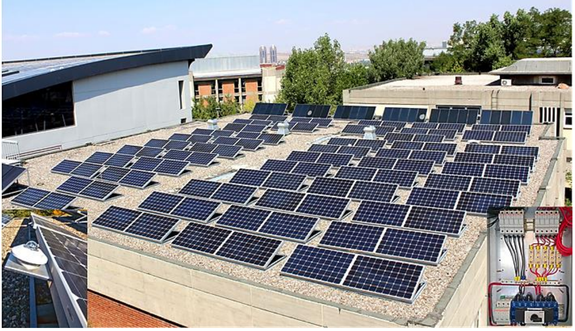
Şekil 2. Çatıya monte edilmiş ve 95 adet CSUN250-72M fotovoltaik modülleri içeren 1000 W/m 2 -25 °C ortam şartlarında 23.7 kW tepe güç üreten fotovoltaik çoklu dizi sistemi (Koordinatlar 39.890917, 32.782278)
