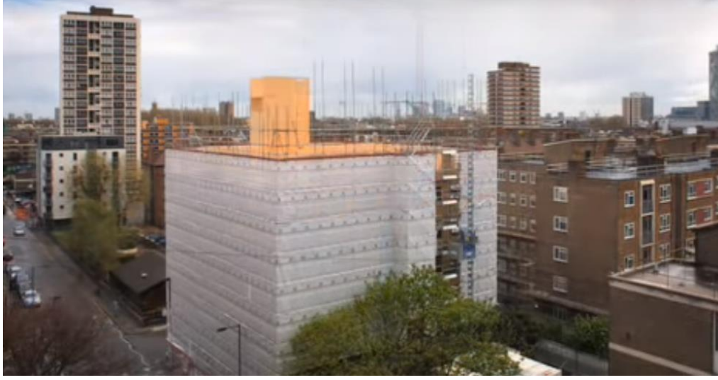
Şekil 9.9. : Murray Grove, İngiltere-projenin yapım aşamasından çekilen bir kare; taşıyıcıları ve zemini ahşaptan yapılmış [81].
