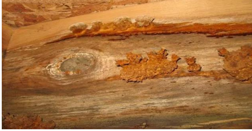
Şekil 3.2.: Mantarların ahşap malzemeye verdiği hasar [13].
