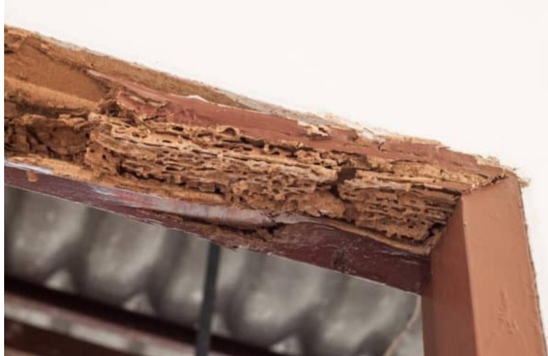
Şekil 3.5. : Termitlerin ahşap malzemeye verdiği hasar [15].
