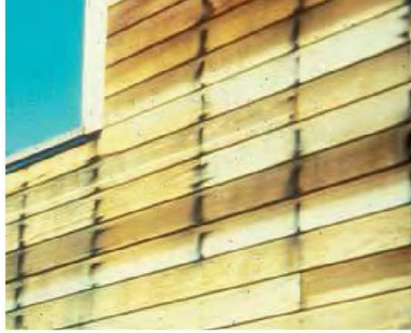
Şekil 5.2. : Ahşap malzeme üzerinde çivinin oluşturduğu korozyon [39].
