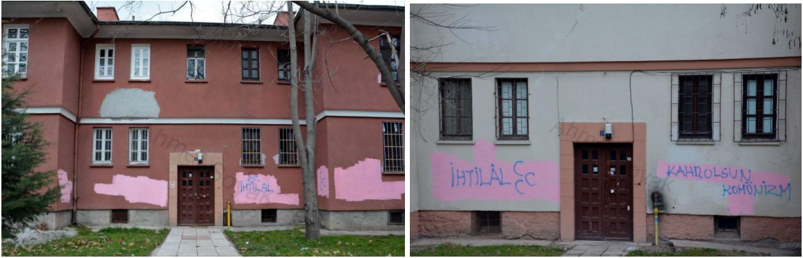
Görsel 4.48: İssızlıktan Kaynaklı Yapıların Cephelerinde Meydana Gelen Hasarlar, 2018, Ufuk Eroğlu Arşivinden
