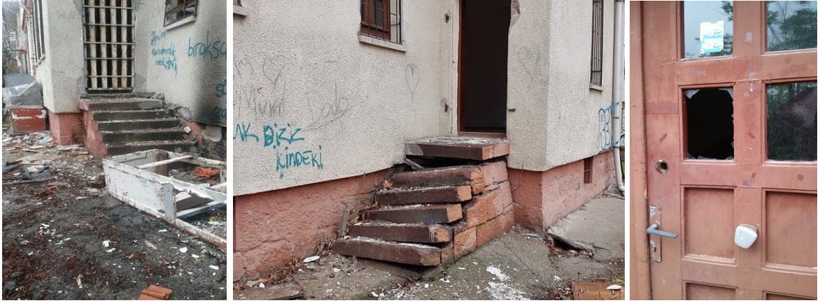
Görsel 4.49: Bakımsızlıktan Kaynaklı Yapıların Cephelerinde Meydana Gelen Hasarlar, 2018, Ufuk Eroğlu Arşivinden
