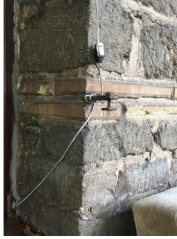
Resim 87: Lojmanın balkon duvarından sarkan kablo (Begüm Gökdağ Arşivi, 2018)
