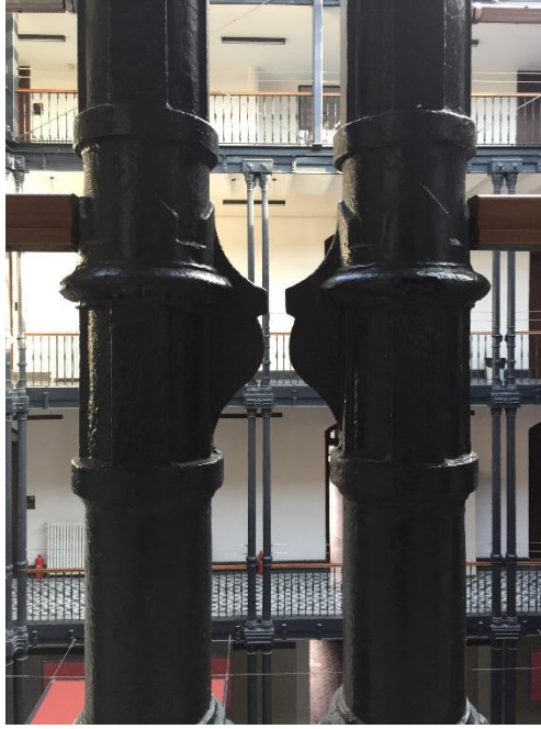
Resim 57: Renovasyon sonrası siyah renge boyanan dökme demir taşıyıcı detayı (Begüm Gökdağ Arşivi, 2018)
