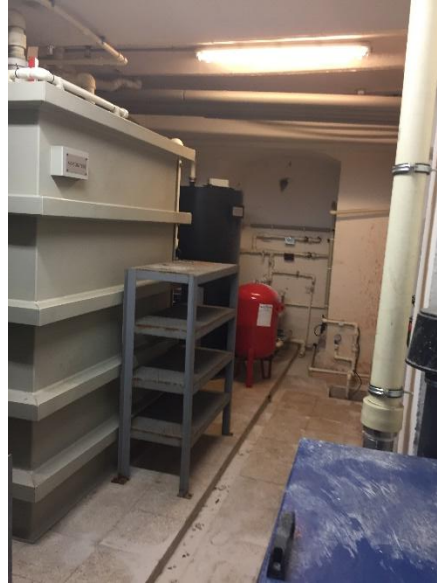
Resim 91: Gri su arıtma sistemi (Begüm Gökdağ Arşivi, 2018)
