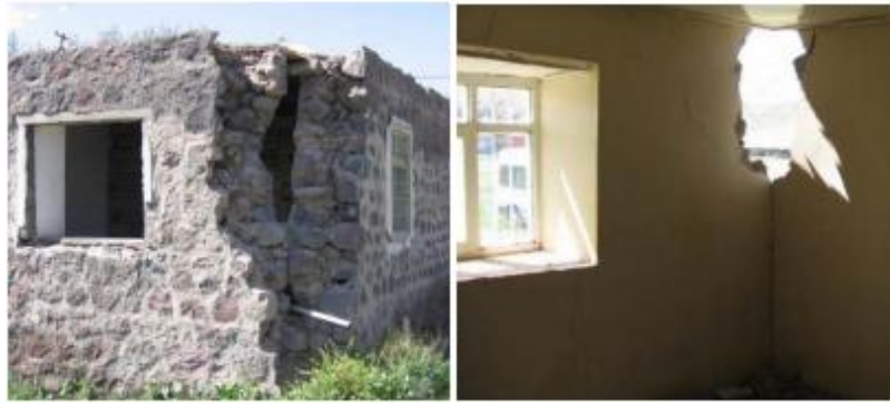
Resim 10: Bloklaşma sonucu yıkılan duvar parçaları (Çırak, 2011)
