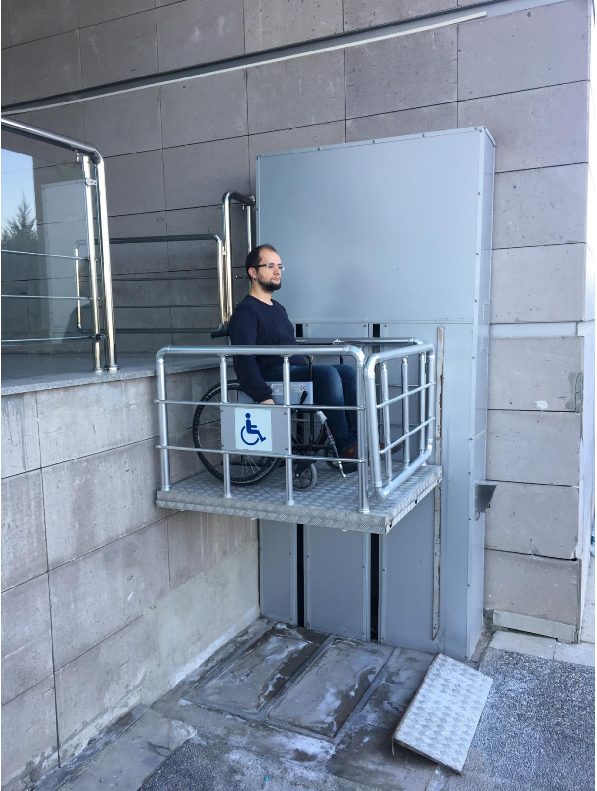
Merdiven asansörü uygulaması, fotoğraf no - 4
