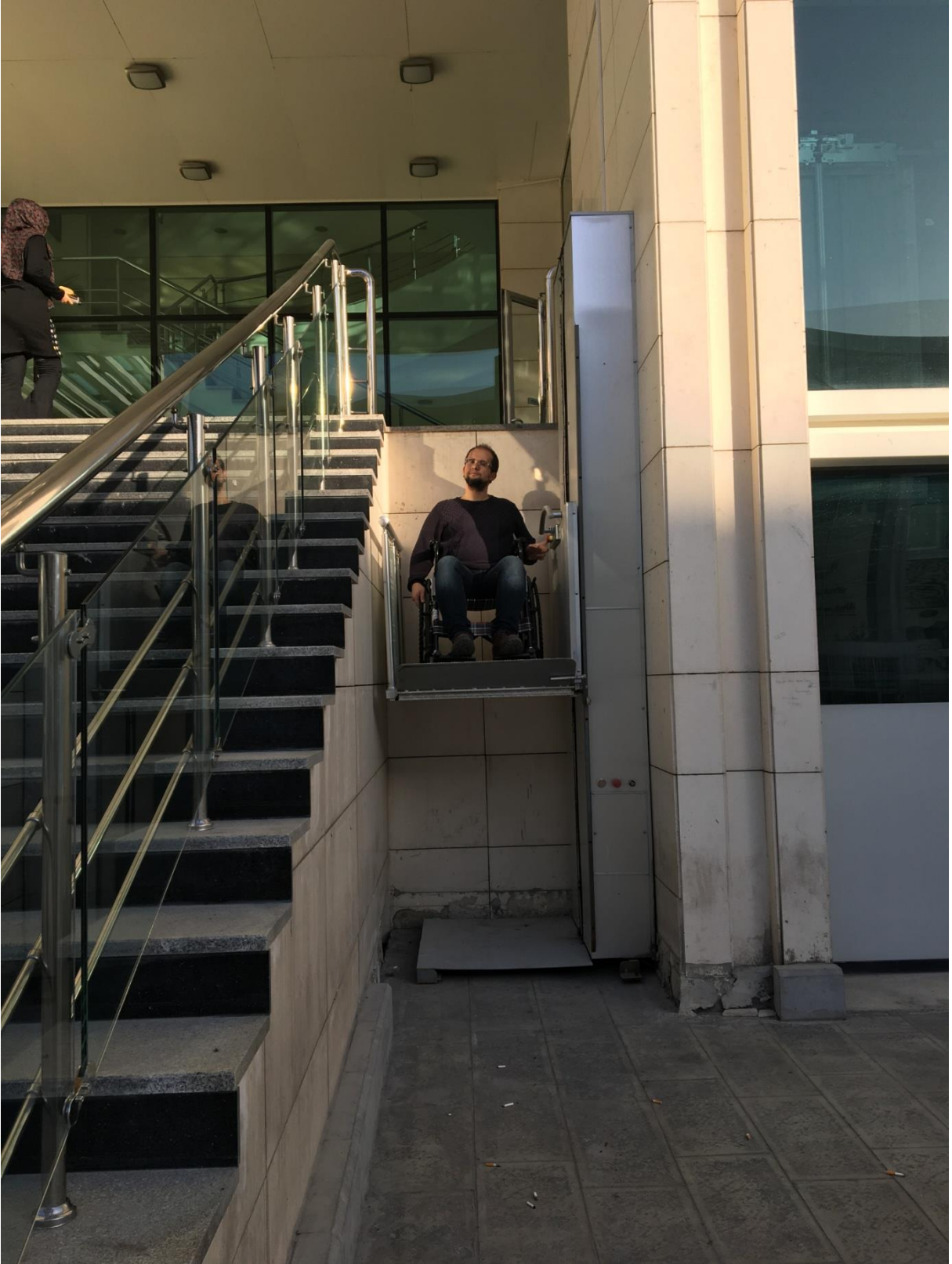
Merdiven asansörü uygulaması, fotoğraf no - 13
