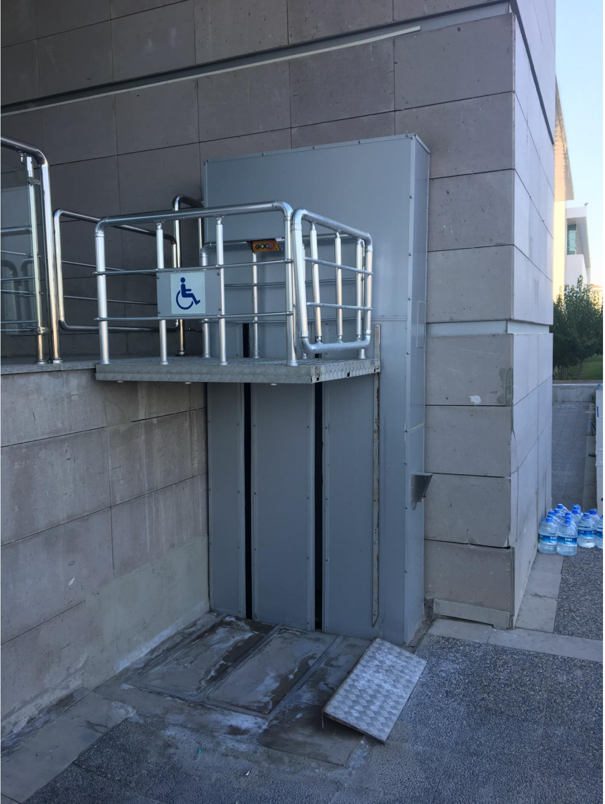
Merdiven asansörü uygulaması, fotoğraf no - 1
