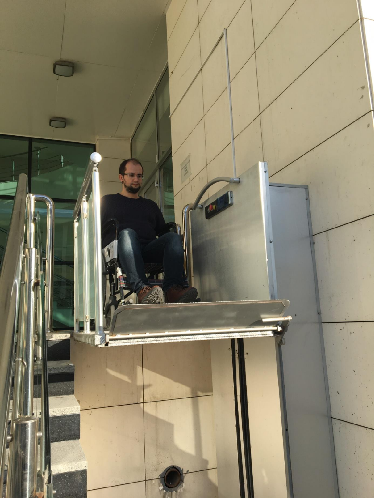
Merdiven asansörü uygulaması, fotoğraf no - 10
