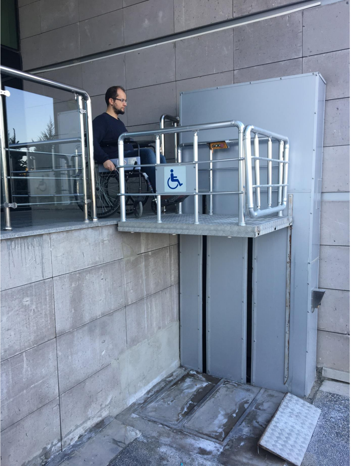
Merdiven asansörü uygulaması, fotoğraf no - 2
