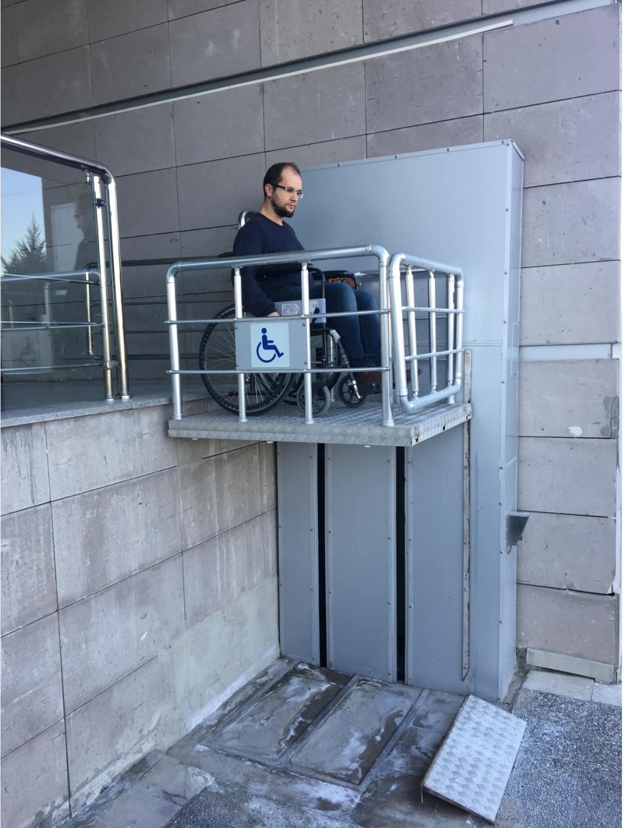
Merdiven asansörü uygulaması, fotoğraf no - 3
