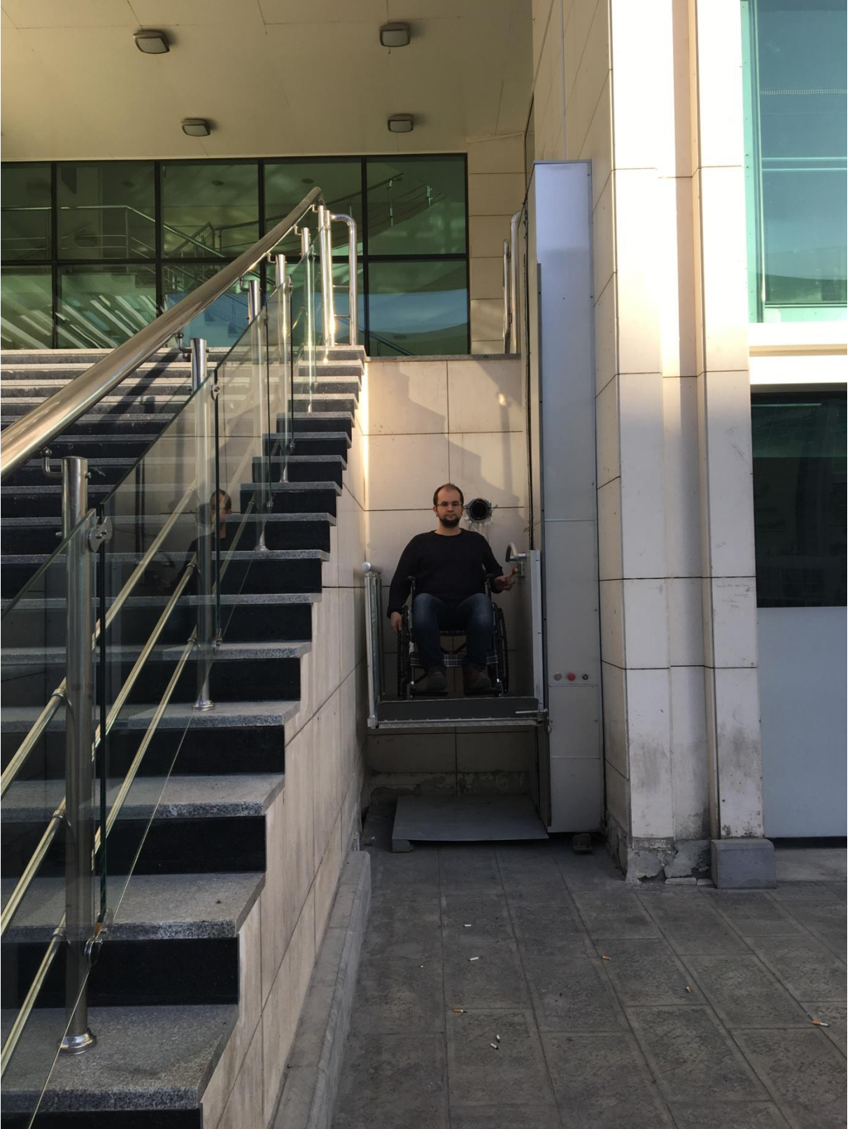
Merdiven asansörü uygulaması, fotoğraf no - 14
