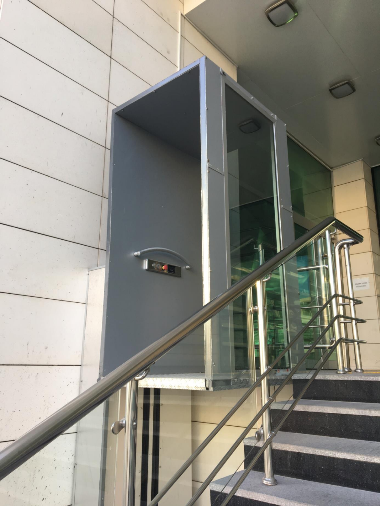
Merdiven asansörü uygulaması, fotoğraf no - 19
