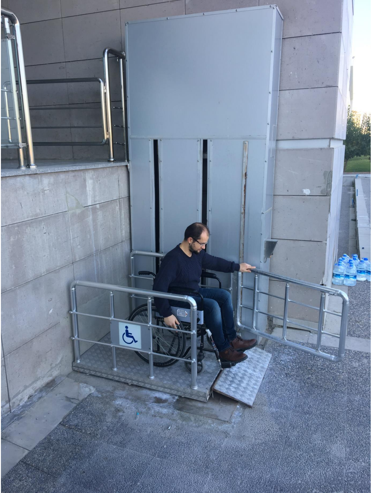
Merdiven asansörü uygulaması, fotoğraf no - 5
