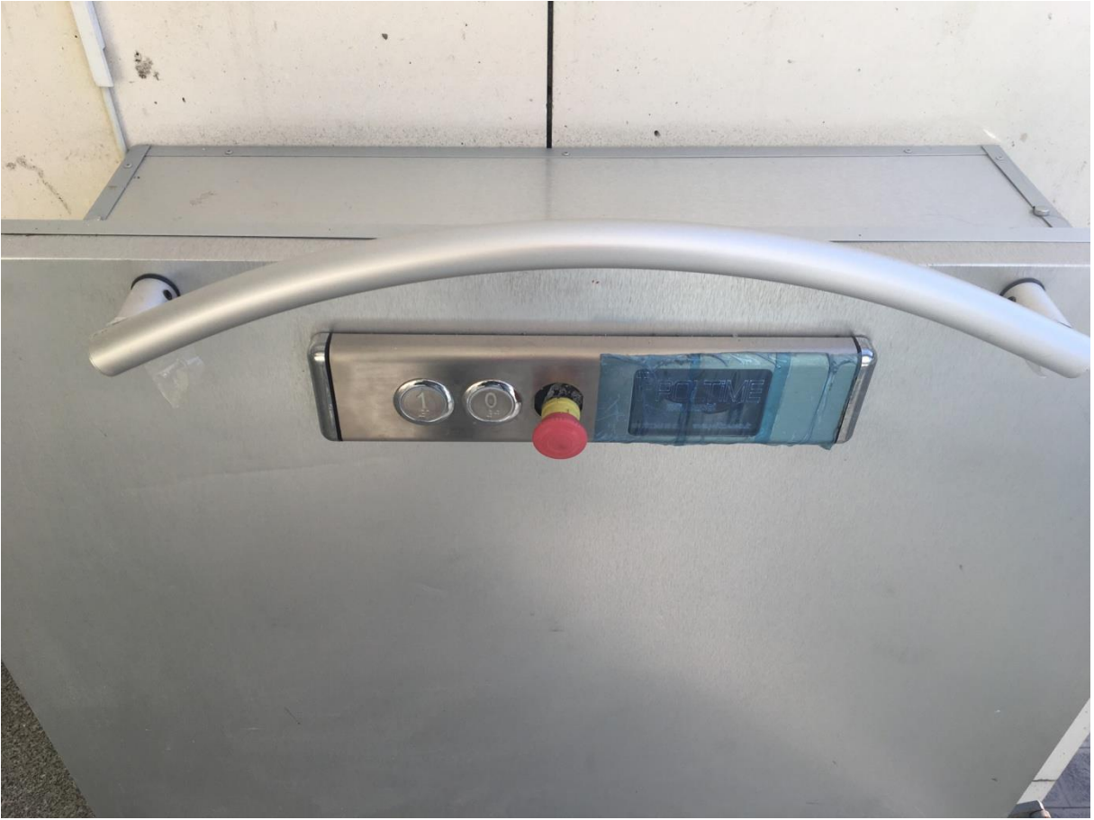
Merdiven asansörü uygulaması, fotoğraf no - 9
