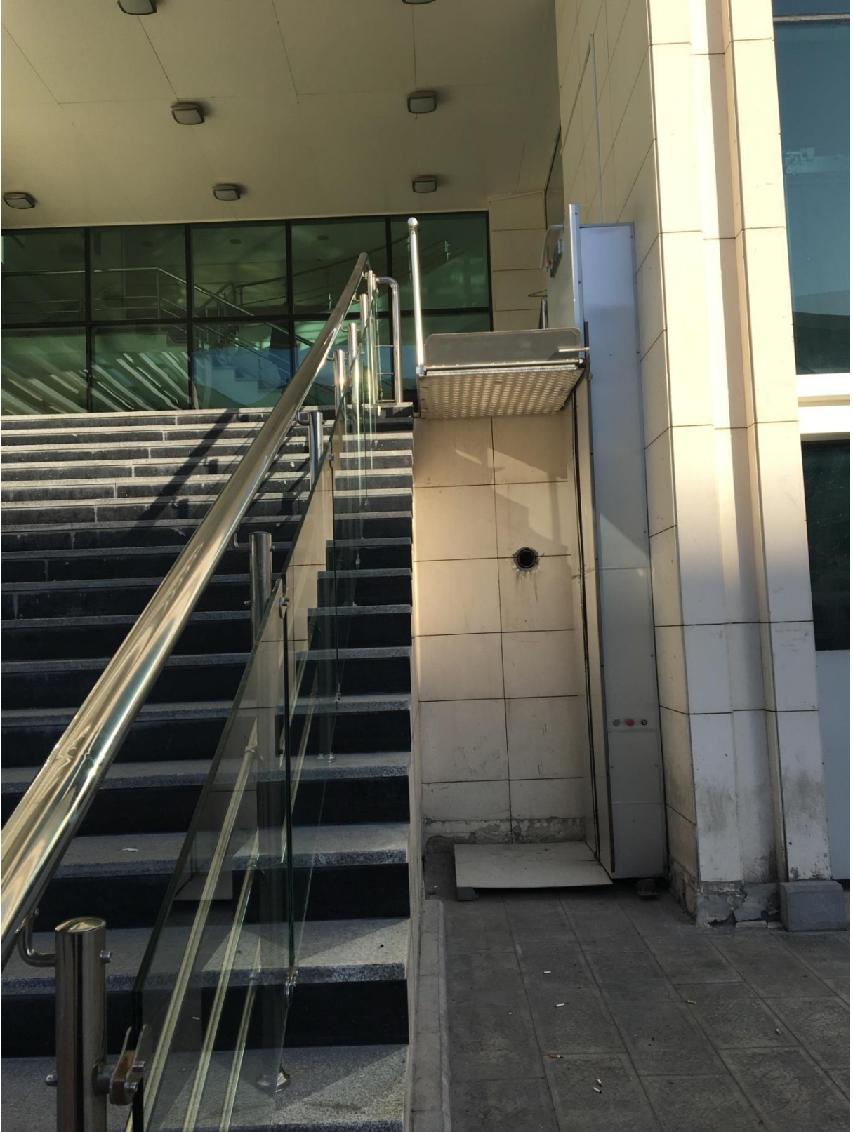
Merdiven asansörü uygulaması, fotoğraf no - 8
