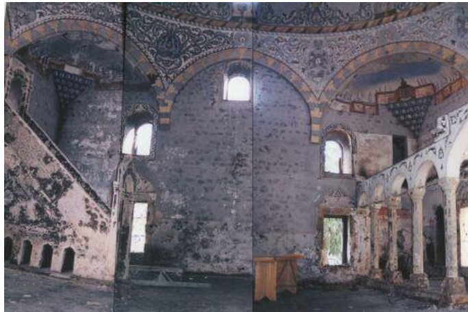
Resim 296: Peja Bayraklı Cami Yangın Sonrası Durumu
