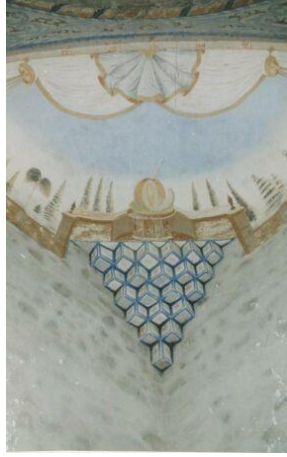
Resim 330: Peja Bayraklı Cami Yangın Sonrası Tromplarda Bulunan Duvar Resmi
