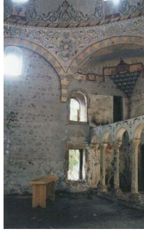
Resim 297: Peja Bayraklı Cami Yangın Sonrası Durumu
