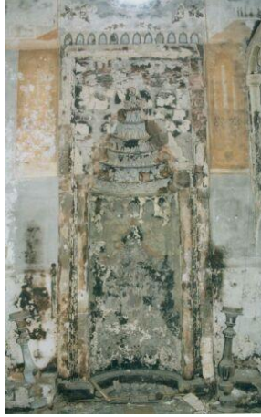
Resim 298: Peja Bayraklı Cami Yangın Sonrası Durumu
