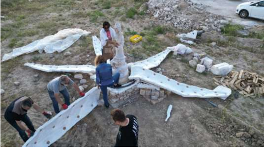
Görsel 101. Taç yaprak fırın yapımı ve fırını oluşturacak yaprakların montajı III Kişisel arşiv
