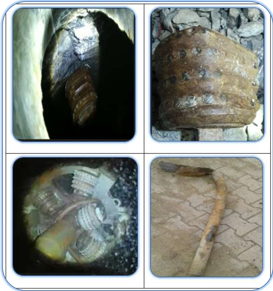
Şekil 7- 5:Sondaj rodunun tarayıcı kafaya dolanması ve üzerindeki kesicileri aşındırması
