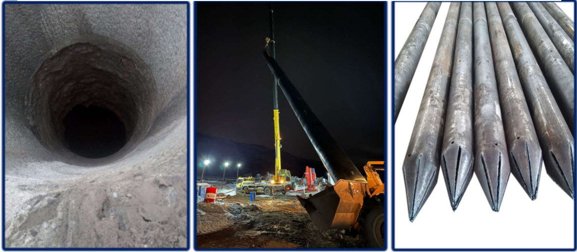
Şekil 7- 19:Sırasıyla tarama sonrası kuyunun durumu, çelik borunun kuyu içine indirilmesi, ilk çelik borunun sivriltilmiş yapısı
