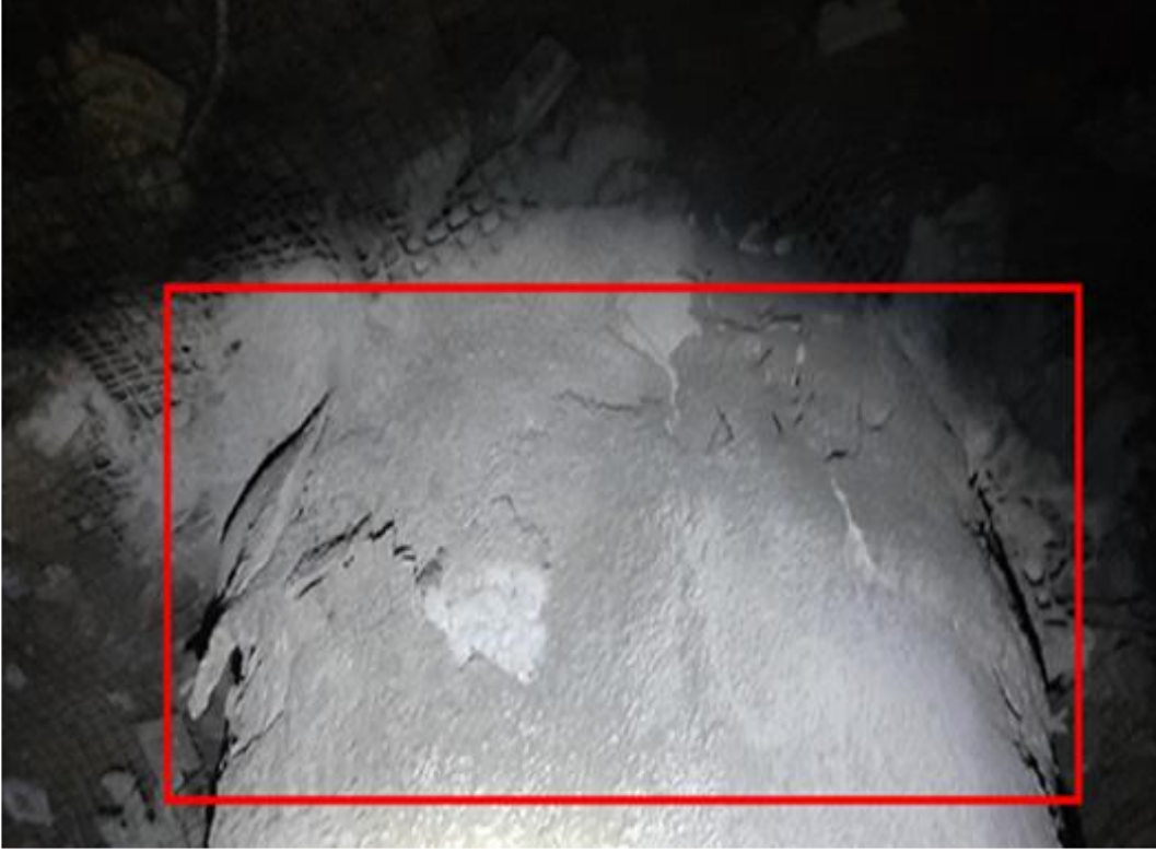
Şekil 5.11. MPBX 04 yakınındaki burkulmuş betonarme topuk
