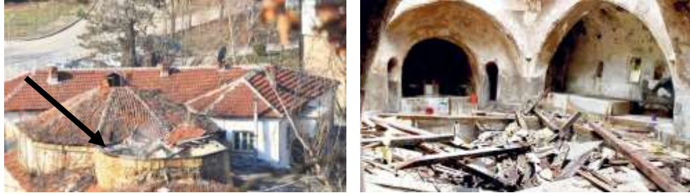
Fotoğraf 213. Novi Pazar Kaplıcası'ndaki Hamam (1593/1594), 2010'da Düşen Çatı
