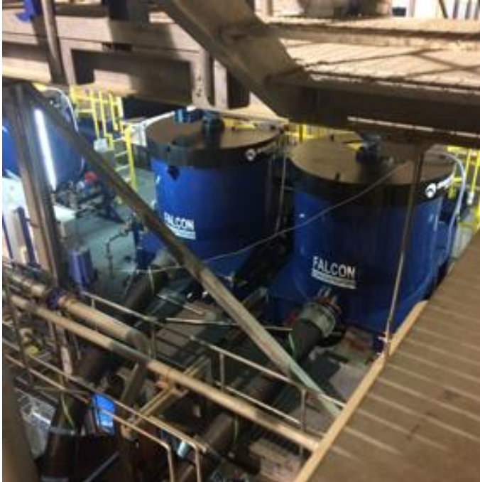
Şekil 2.19 Falcon kesikli zenginleştiricilerinin tesis içerisindeki görünümü
