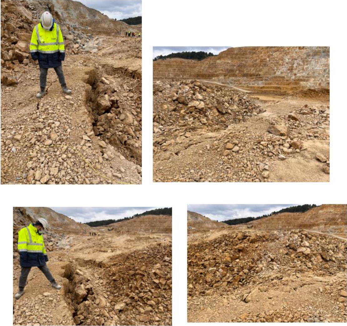
Şekil 3.27. Patlatma sonrası gerilme çatlakları ve parçalanmış kaya malzemesi
