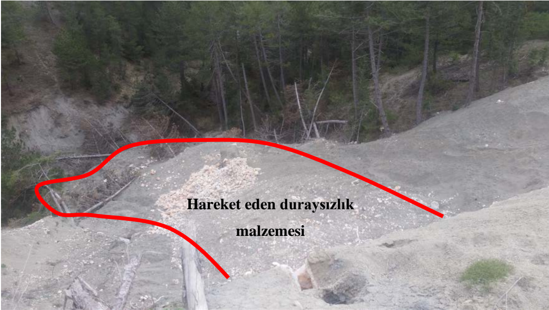
Şekil 4.1. (a) Duraysızlığın kayma yüzeyi ile yıkılan duvardan bir görünüm ve (b) vadi içerisine doğru hareket eden duraysızlık malzemesi.
