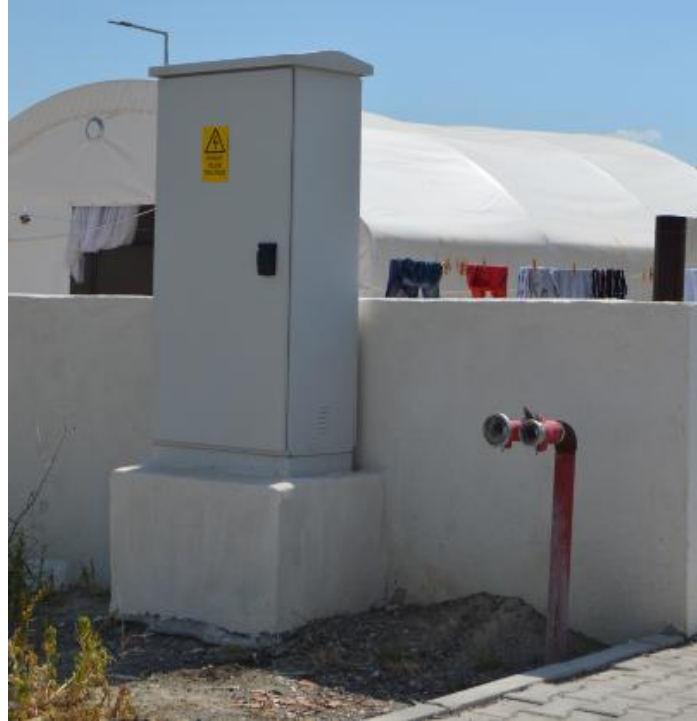
Görsel 95. Sarıoba Yerleşkesindeki Hidrantlar (Yangın Muslukları) (Araştırmacı tarafından çekilmiştir)
