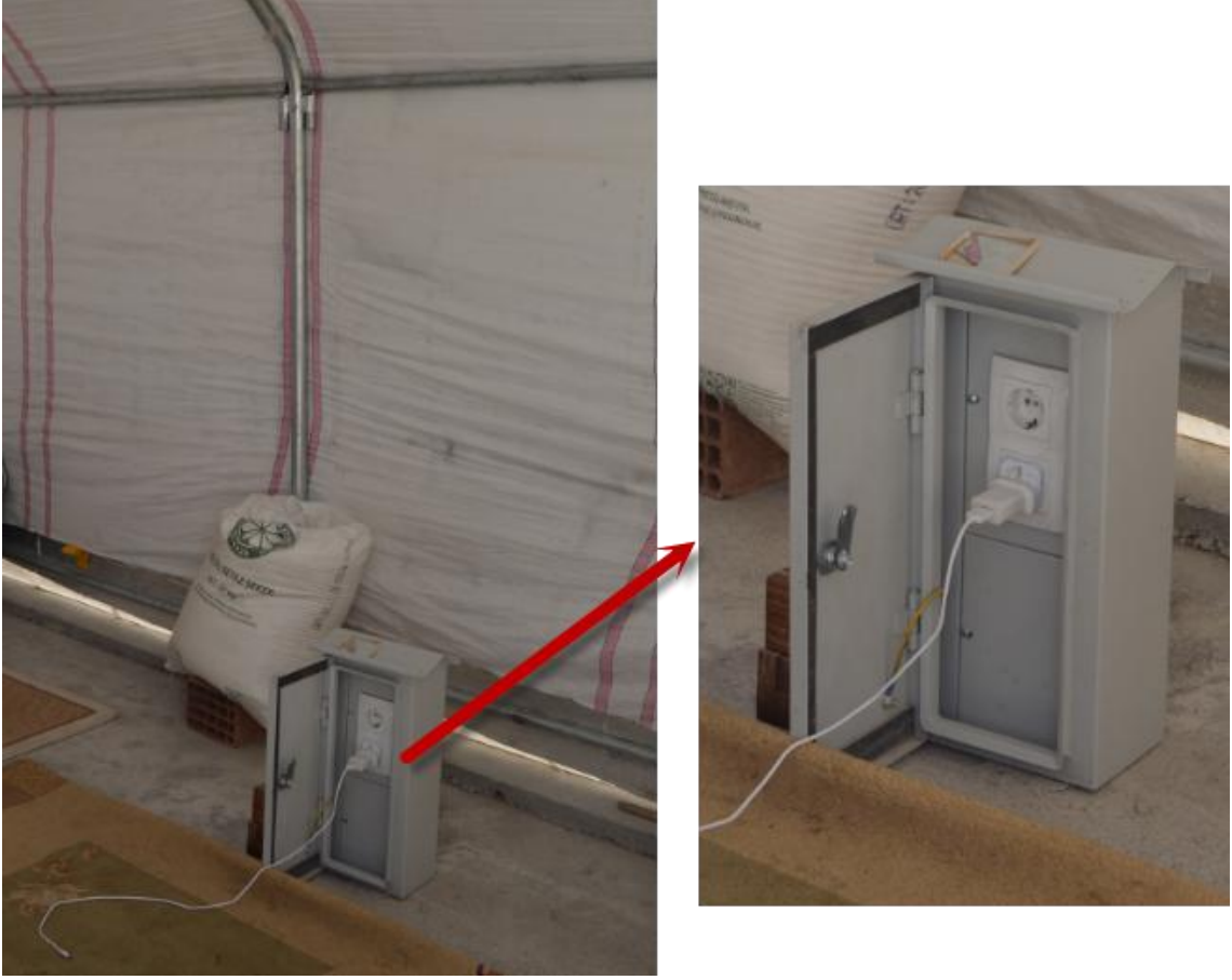
Görsel 114. Çadırlarda Bulunan Prizler (Araştırmacı tarafından çekilmiştir)
