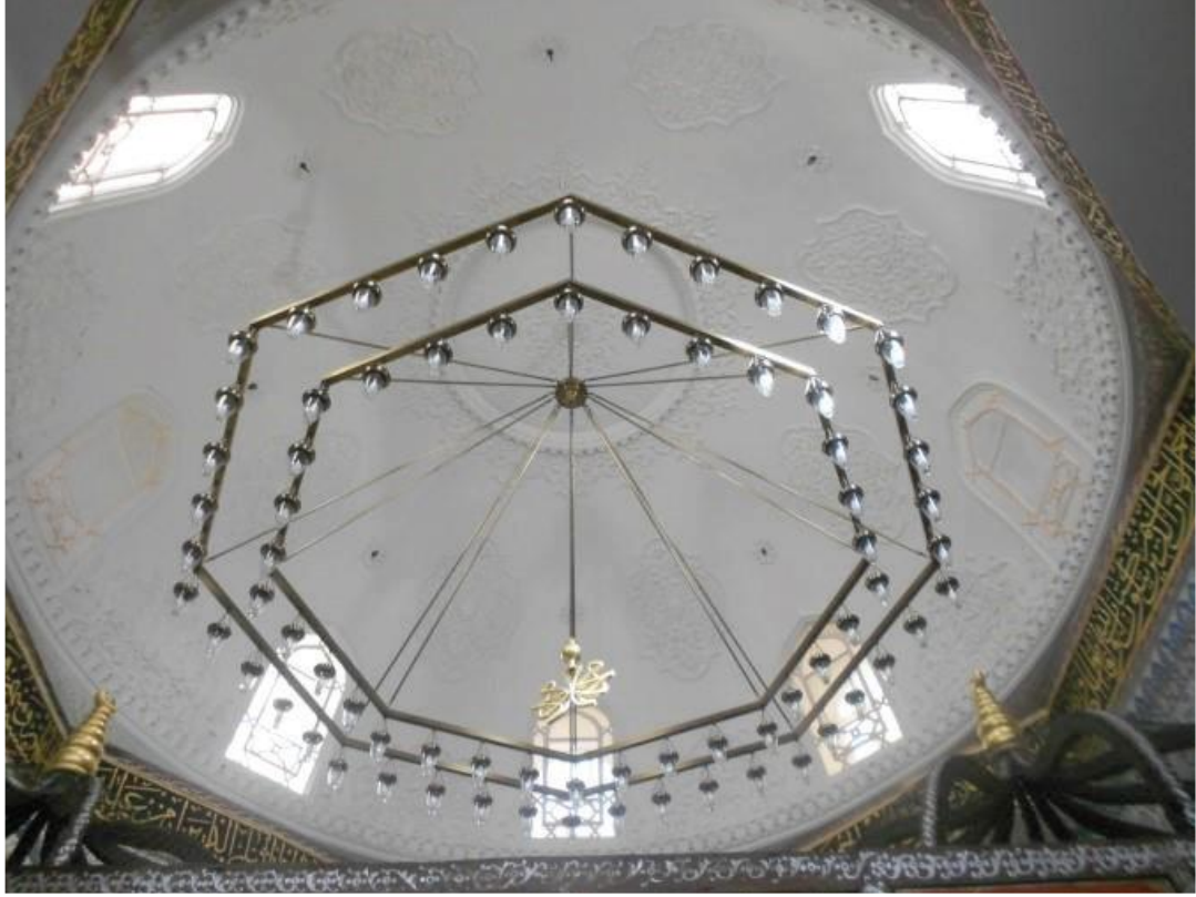
Resim 105. Ayasofya Kütüphanesi, Restorasyondan Sonra Hazine-i Kütüb Bölümünün Kubbesi (Can ve diğerleri, 2015, s. 207)
