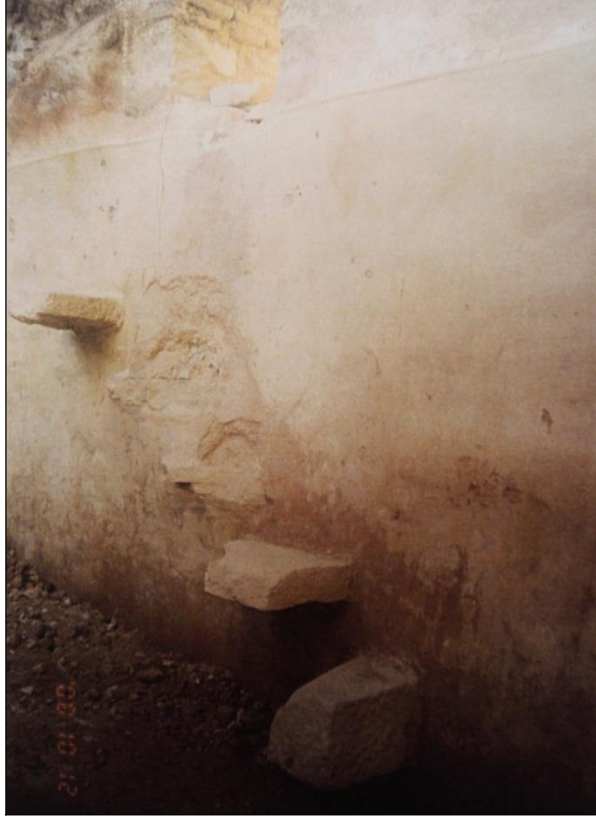
Şekil 54 : Eskihisar Kalesi, sarnıcın batı duvarındaki açıklık ve basamaklar (Aksoy, 2000, İzmit Arkeoloji Müzesi Arşivi).
