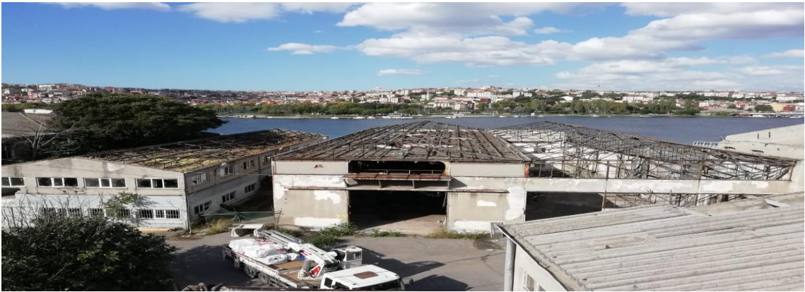
Şekil 4.15. Çatısı sökülmüş yapılara ait görüntü.
