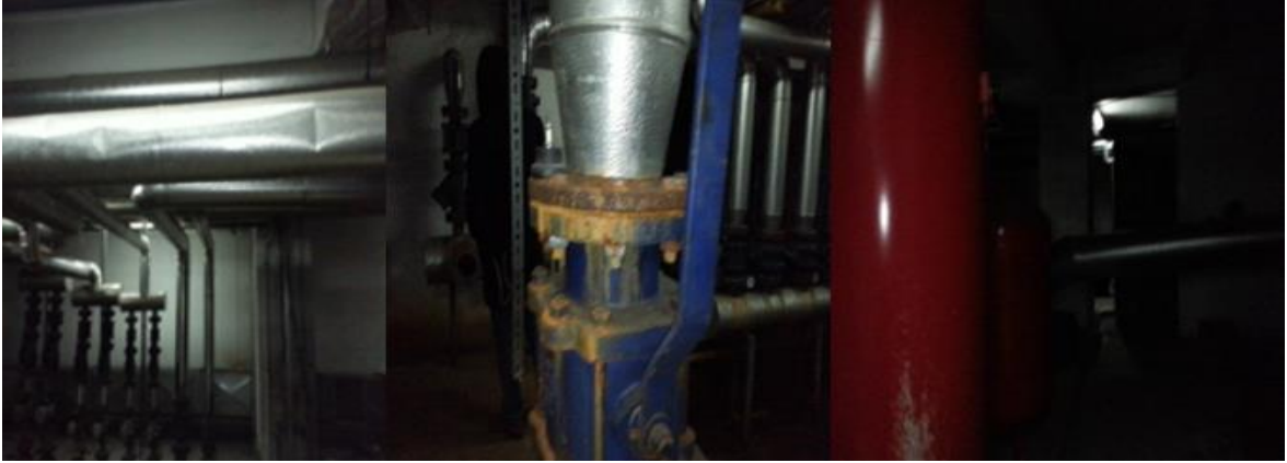
Şekil 4.6. Kazan dairesi boru hatları.
