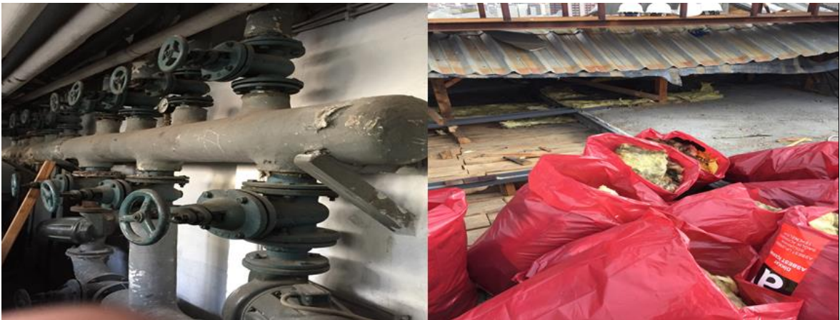
Şekil 5.2. Asbest bulunan boru hatları ve çatı malzemeleri.
