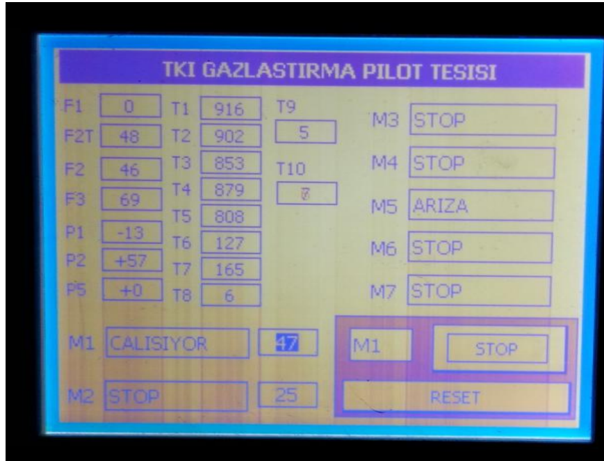
Şekil 4.1. Akışkan Yatak Sistemi Kontrol Paneli
