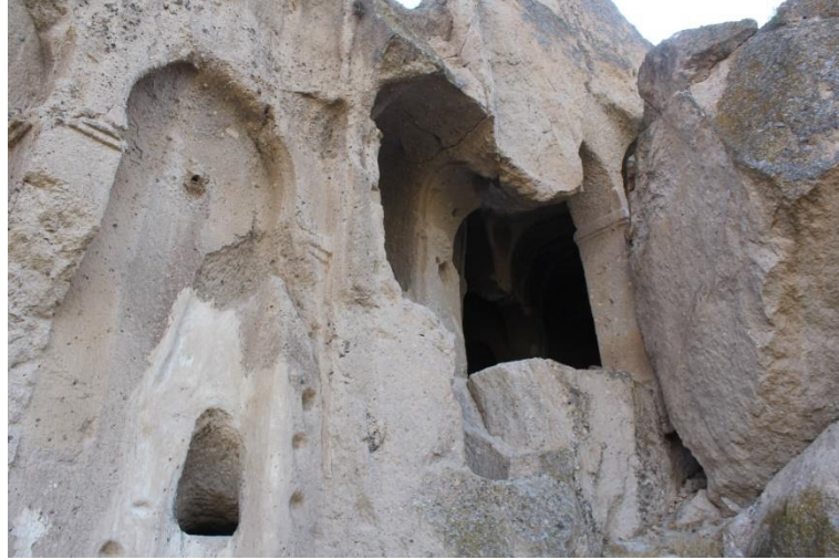
resim 137. Soğanlı Han kompleksi, Doğu kilise, kompleksin kuzey cephesini hareketlendiren kemerlerden biri ve kilisenin giriş mekanı ile naosu
