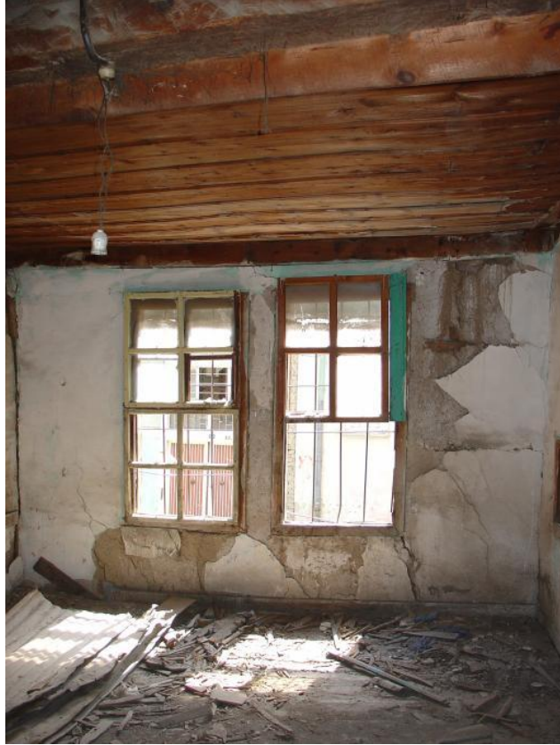
Görsel 90. Gaydaroğlu Konağı Sanat Merkezi, restorasyon öncesinde iç mekân duvarlarındaki deformasyonlar.Necmettin Eryılmaz fotoğraf arşivi.
