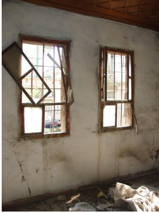
Görsel 73. Gaydarođlu Konađı Sanat Merkezi, Z-03 oda bölümünün batı cephesinde bulunan ½ oranında yapılmıř restorasyon öncesindeki ahřap pencereler. Necmettin Eryılmaz fotoğraf arřivi.
