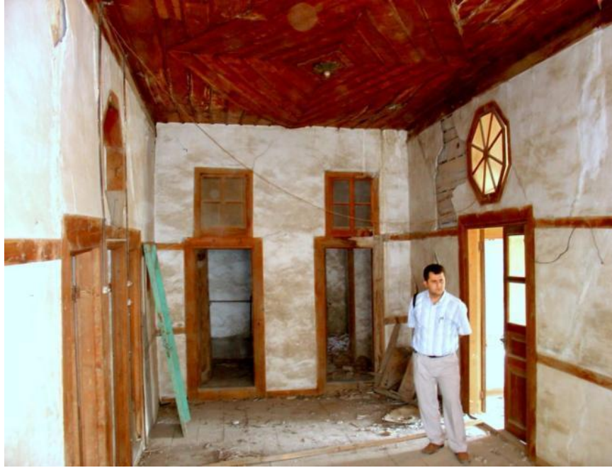
Görsel 77. Gaydaroğlu Konağı Sanat Merkezi, 1-04 sofa bölümünün güney cephesinde bulunan sonradan eklenmiş restorasyon öncesindeki ıslak hacim görünümü. Necmettin Eryılmaz fotoğraf arşivi.
