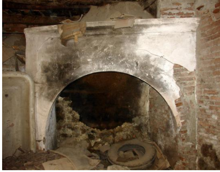
Görsel 67. Gaydarođlu Konađı Sanat Merkezi, B-01 bodrum katı bölümünün dođu cephesinde bulunan restorasyon öncesinde tuđla ile yapılmıř bađ ocađı. Necmettin Eryılmaz fotoğraf arřivi.
