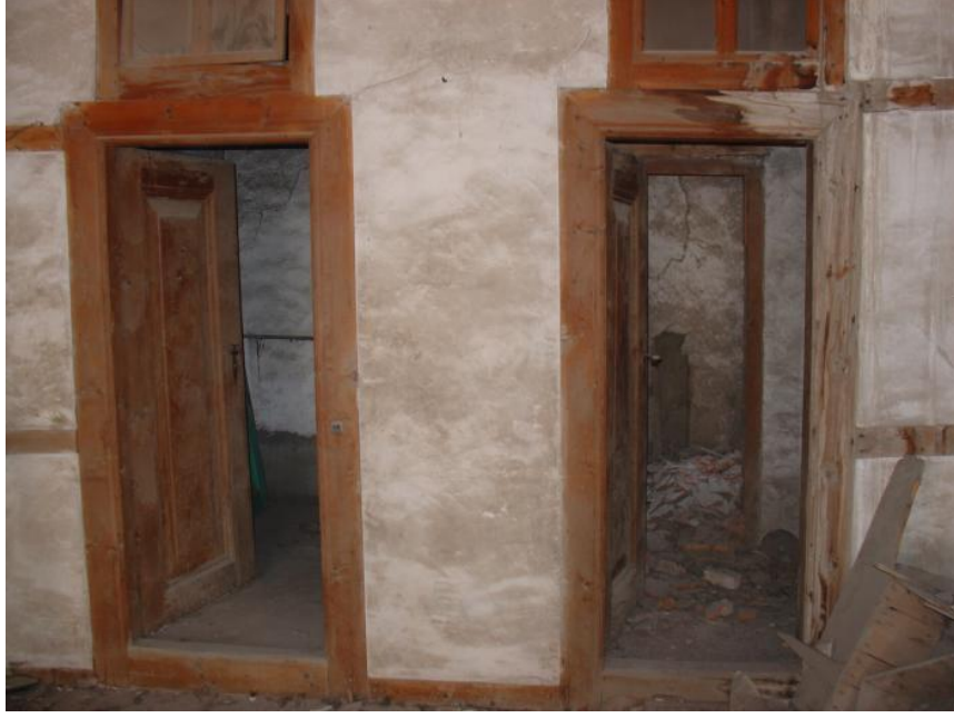
Görsel 79. Gaydaroğlu Konağı Sanat Merkezi, 1-04 sofa bölümünün güney cephesinde bulunan sonradan eklenmiş restorasyon öncesindeki ıslak hacim görünümü. Necmettin Eryılmaz fotoğraf arşivi.
