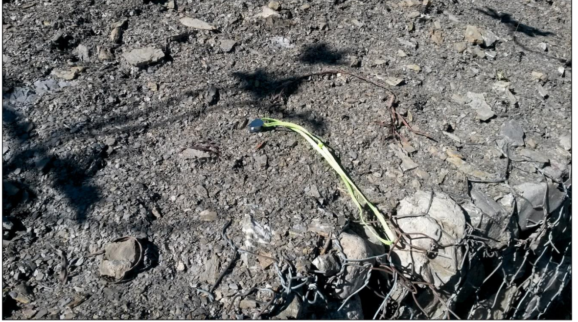
Şekil 3.3. Çalışma sahasında görülen şist biriminin yakından görünümü; kaya malzemesi oldukça zayıf görülmektedir.
