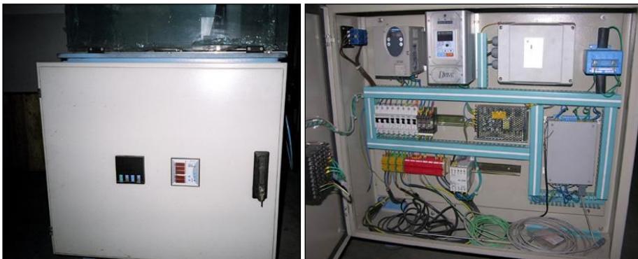
Şekil 3.8. Elektrik panosunun iç ve dış görünümü
