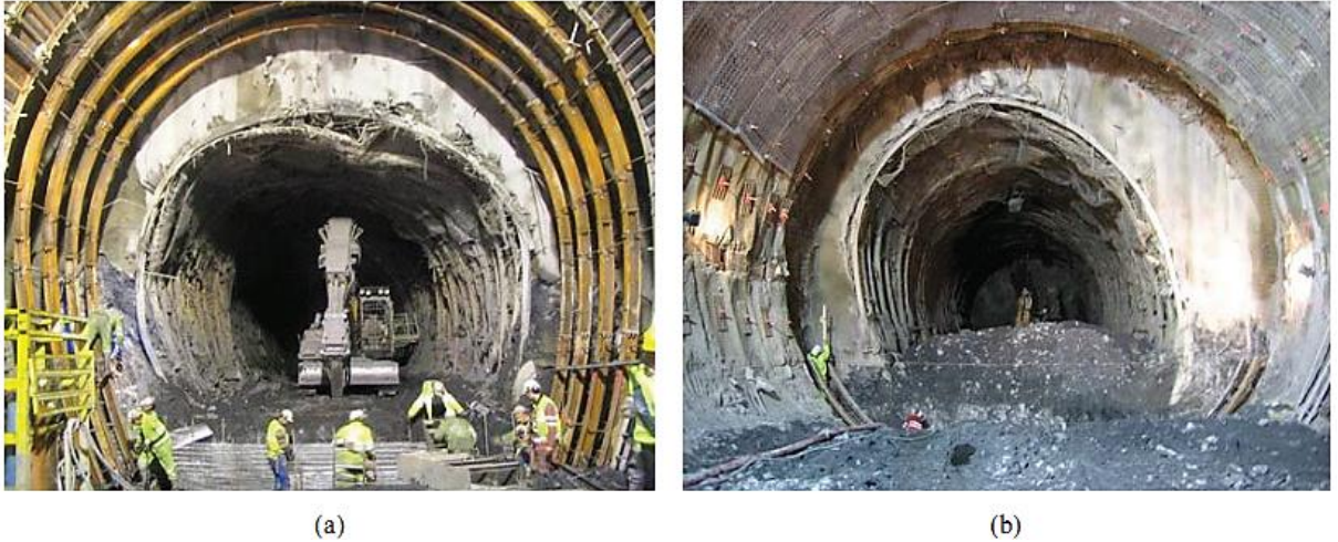
Şekil 1.1. Saint Martin La Porte’de galeri ağzında sıkışan kayanın tünel kesitini azaltması.
