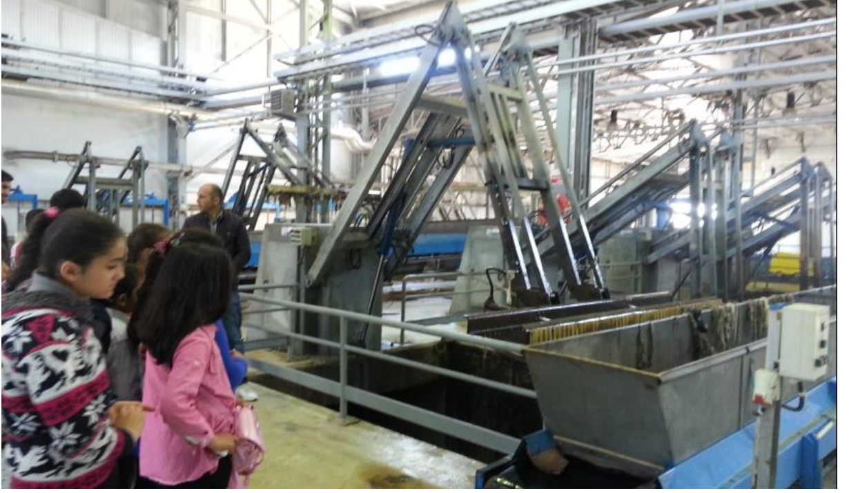
Atık Su Arıtma Tesisi
