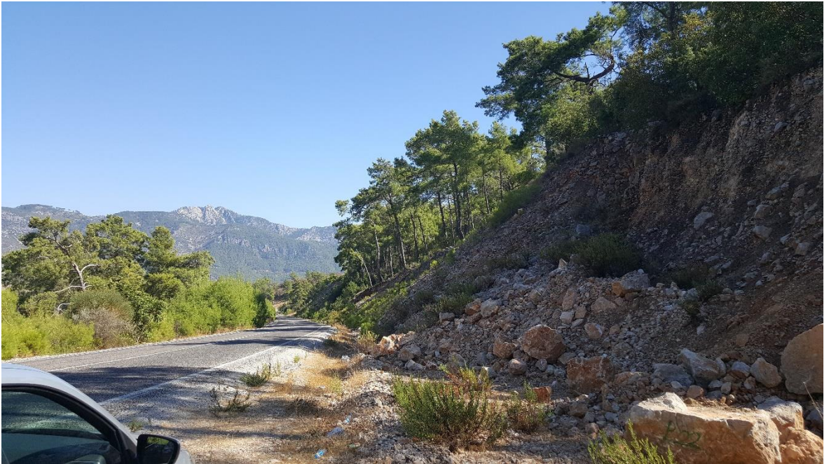
Şekil 3.3. Adrasan ve çevresinde yol kesmesi sonucu gelişen heyelanlarda ağaçların aşağı doğru yönelimine ait örnek fotoğraf
